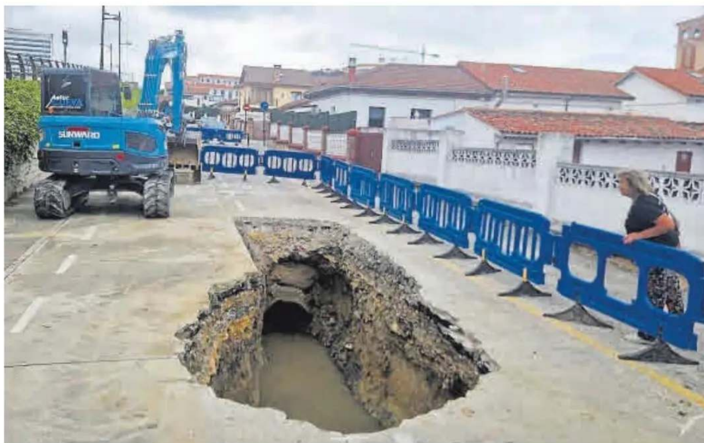
Una vecina asomándose este jueves al gran socavón de la calle Jacintos de Guillén Lafuerza.
